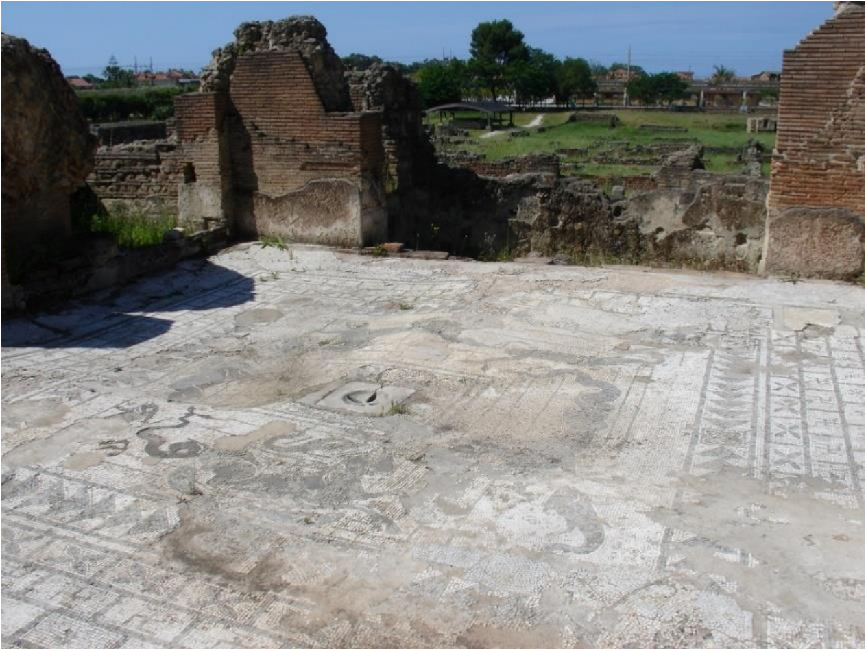
Figura 1-Terme Imperiali – Mosaico. Colonizzazione biologica. Perdita di coesione delle malte. Perdita elementi.
