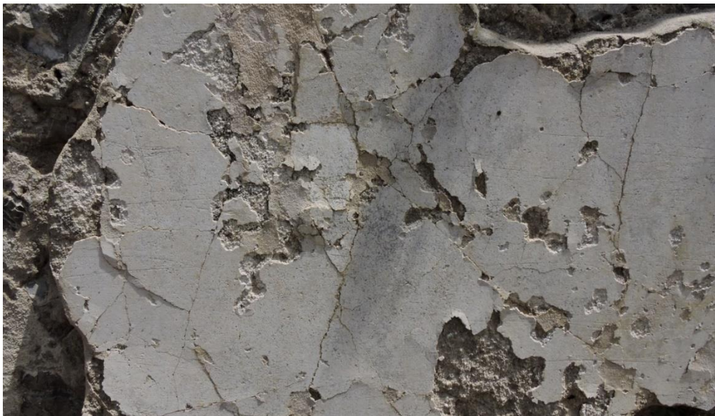
Figura 7-Insula II – criptoportico. Intonaco sollevato e soggetto a rigonfiamento
